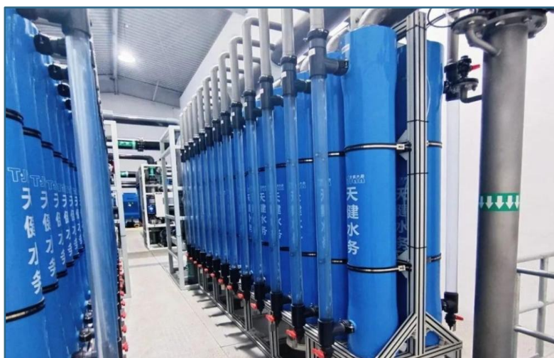
Figura 6. Planta completa de membranas cerámicas en columna
