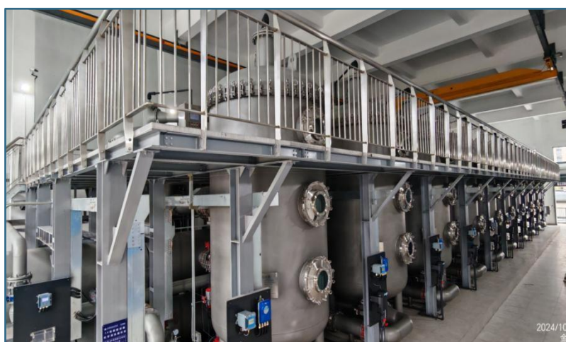
Figura 7. Sistema completo de membranas cerámicas en tanques
