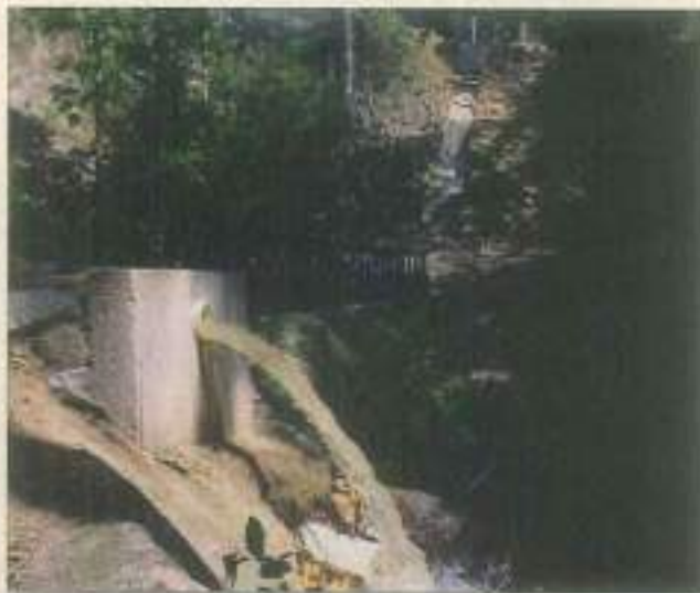
Ilustración 15. Desarenador río Piedras.
