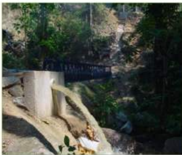
Ilustración 15. Desarenador río Piedras.
