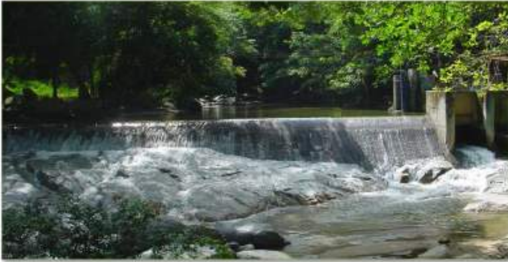
Ilustración 9. Captación río Manzanares.
